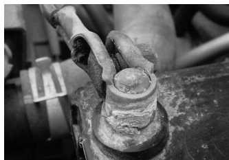
腐食したターミナル
