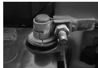
亀裂が入ったターミナル
